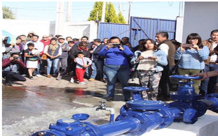
Foto 21. Sistema de agua potable "Los arcos"
