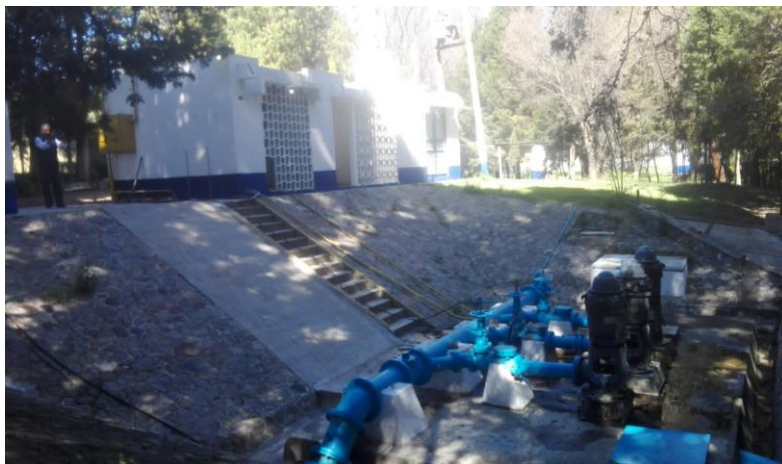
Foto 22. Sistema de abastecimiento "El Parral"
