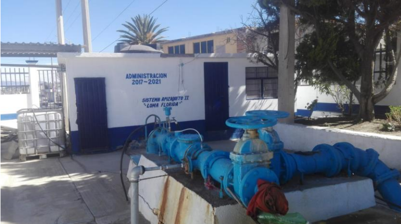
Foto 25. Sistema de agua potable "Loma Florida" (Apizaquito 2)
