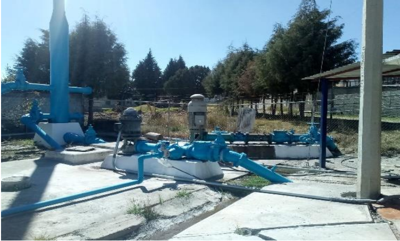
Foto 24. Sistema de agua potable "Actipan".
